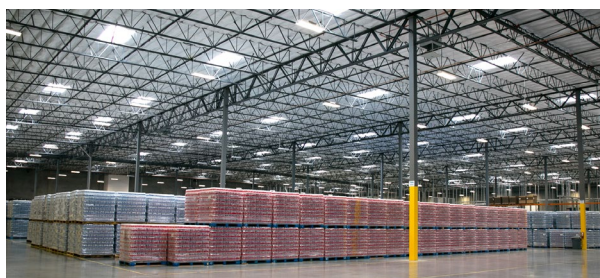
Instalacja LED w posiadającym certyfikację LEED na poziomie Gold Prologis Park Cheyenne w Las Vegas w Nevadzie
