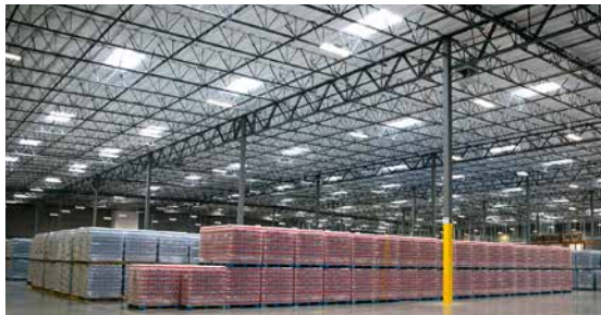
LED világítótestek a LEED Gold tanúsítvánnyal rendelkező Prologis Park Cheyenne épületében (Las Vegas, Nevada).
